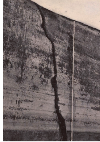
Risse in der Mauer
